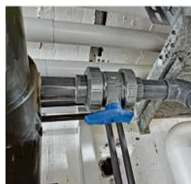
Die reparierte Stelle. Die Verbindungsmuffe rechts neben dem blauen Kugelhahn war gerissen und hätte fast für eine Katastrophe gesorgt. Foto: wp
